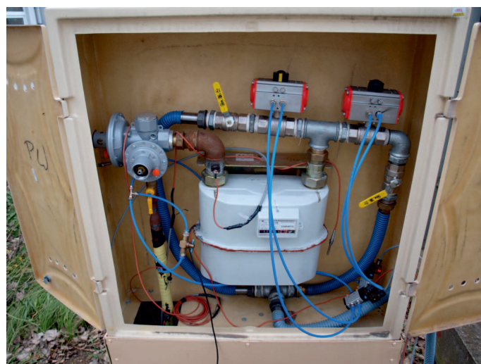
Rys. 5. Widok przemysłowego gazomierza miechowego G10 wyposażonego w układ sterujący cyklicznymi zmianami strumienia objętości
